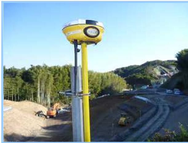
図-7 基地局設置状況
