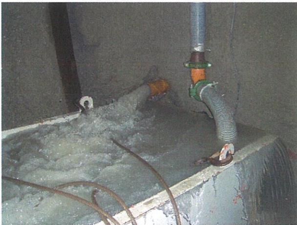
写真-3 大量湧水状況
