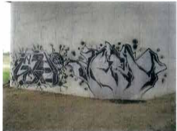
写真-3 橋脚になされた落書き2
