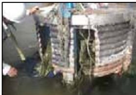
写真-4 対策前の取水部の状況
