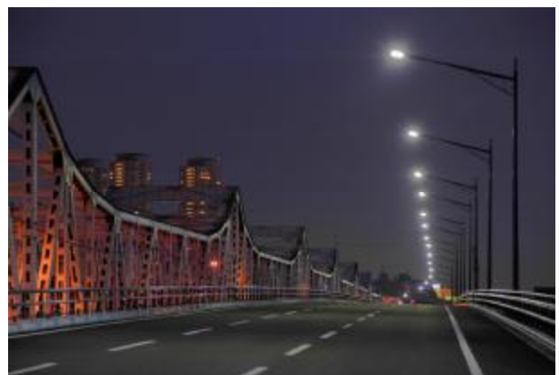
図-2 LED道路照明設置事例(府道大阪中央環状線鳥飼大橋)
