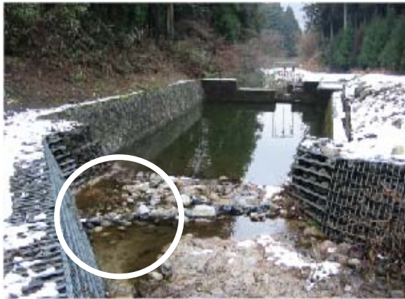
写真-4 流況の悪化で取水が困難 (朝古川水系木落川水源, 2016年に予備化)
