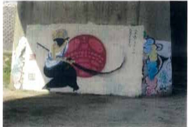
写真-2 橋脚になされた落書き
