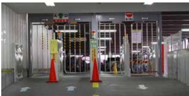
写真-5 自動ゲート
