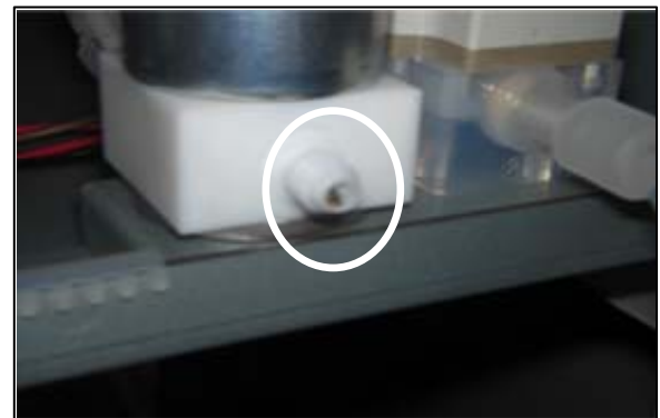
写-16 バルブ出入口で目詰まり
