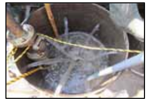
写真-7 注水状況
