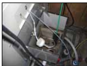
写 17-③ 砂除去フィルター
