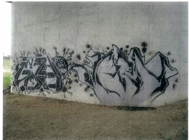
写真-3 橋脚になされた落書き2
