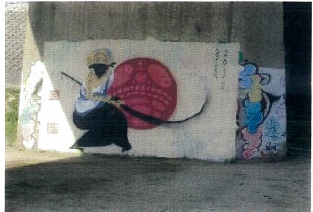
写真-2 橋脚になされた落書き
