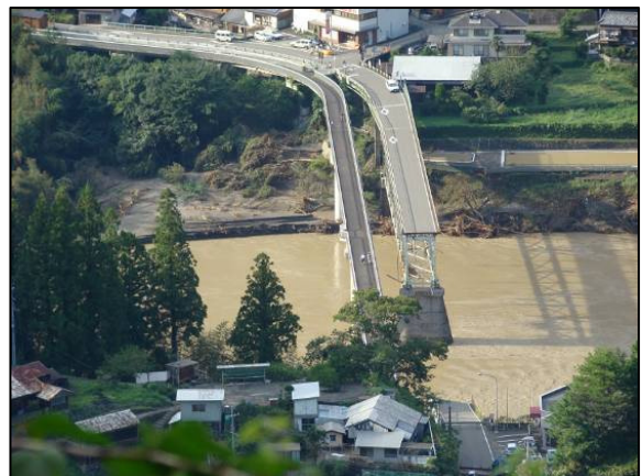
図-2 折立橋の落橋
