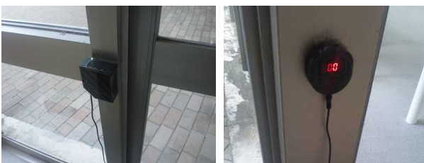
図-12 物産館と情報館の入口に設置した人感センサー
