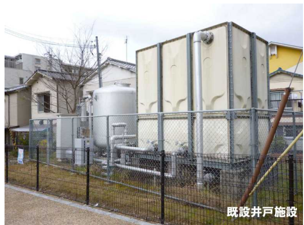
図4 せせらぎ水路ポンプ施設
