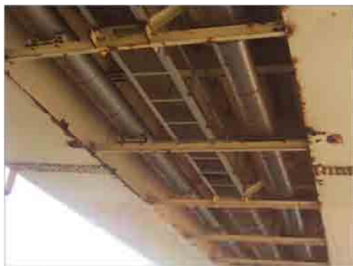
写真-1 ボルト、下フランジの錆(三国大橋)
