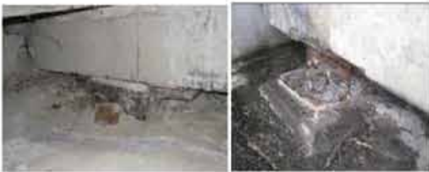
写真-1 鋼製支承腐食状況
