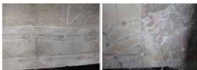
【主桁下ラジ部ひび割れ（橋軸方向）】
