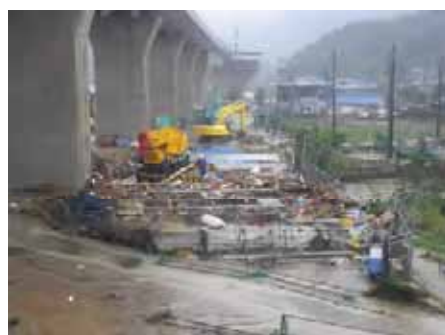
写真-3 現場内 (土砂・ガレキの堆積)
