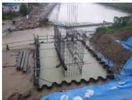
写真-4 床掘水没状況
