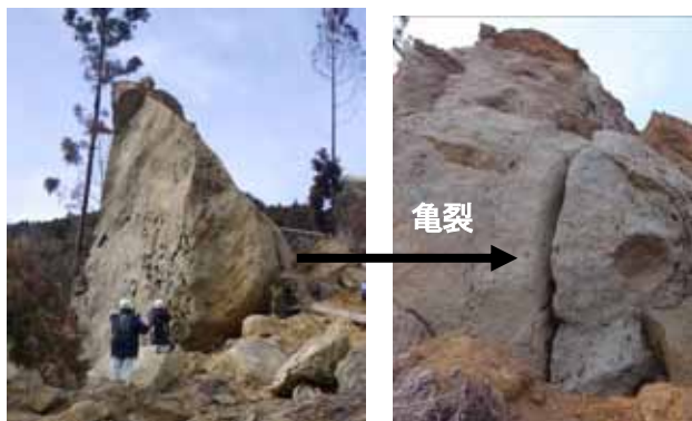
図-4 崩壊地内の岩塊の状況 (浮石上となった岩塊背後に明瞭な亀裂が認められる)
