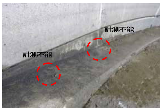
図-4 基礎排水孔の流失状況
