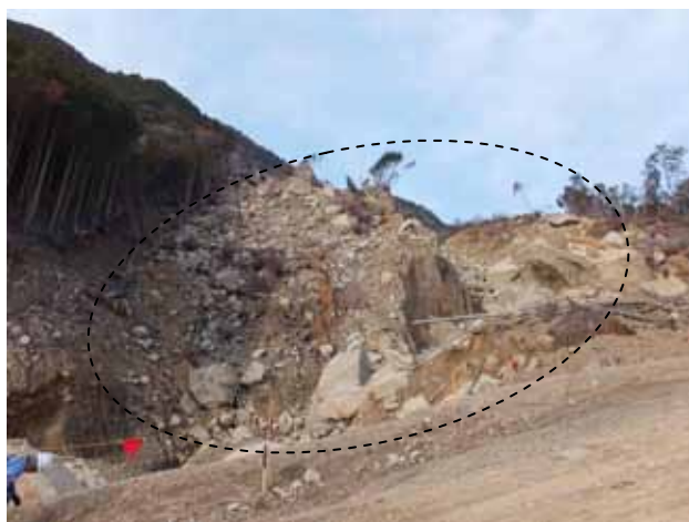
図-3 崩壊地 下流側末端部の状況 (施工エリアより撮影)
