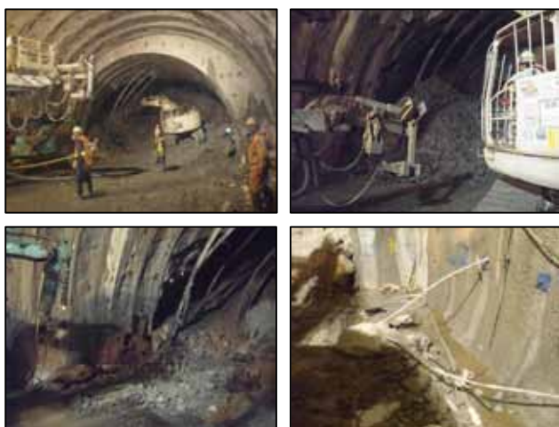
写-3 崩落直後の状況
