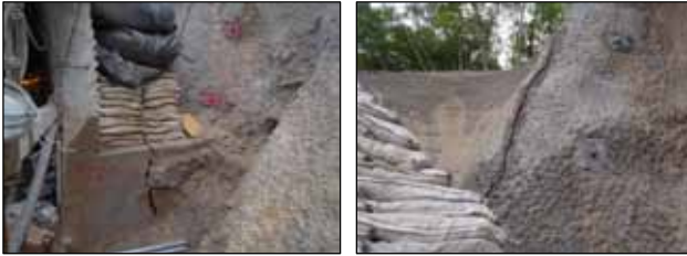
写-1 坑口部の変状状況
