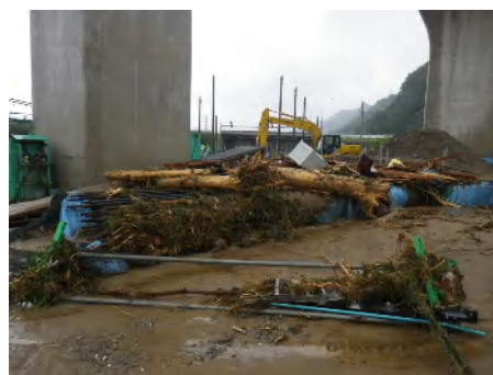
写真-5 現場保管鉄筋埋没状況
