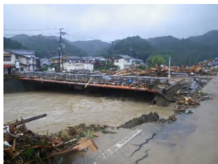
写真-1 川関橋損壊状況
