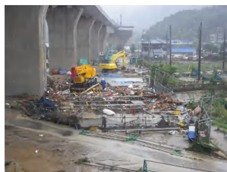
写真-3 現場内（土砂・ガレキの堆積）
