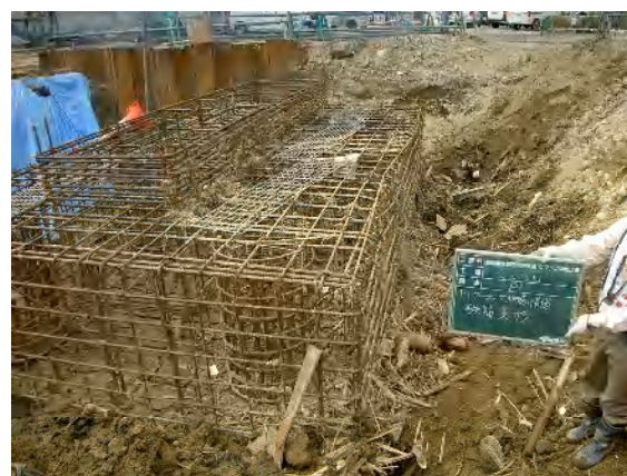
写真-8 P1橋脚フーチング鉄筋被災状況
