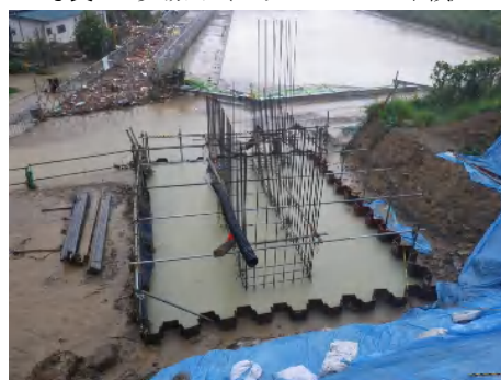
写真-4 床掘水没状況
