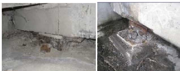
写真-1 鋼製支承腐食状況
