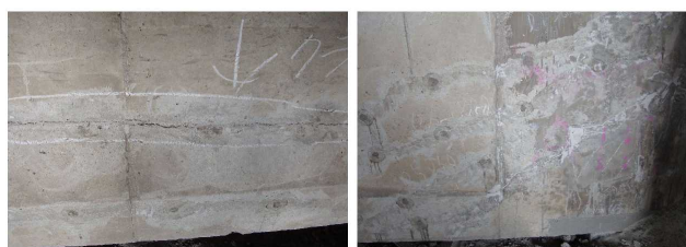
【主桁下ラジ部ひび割れ(橋軸方向)】
