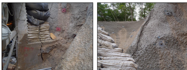
写-1 坑口部の変状状況
