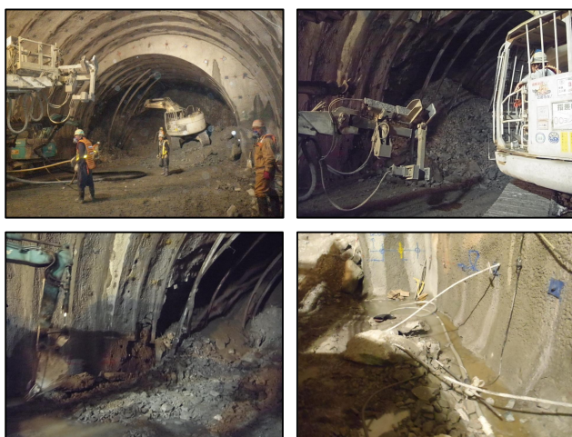
写-3 崩落直後の状況
