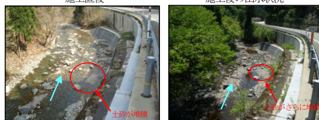
出水後の状況
