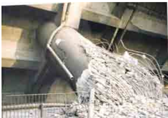
図-16 神 P134(南西面) 20) (柱の南西面に大きな斜め割裂塊)
