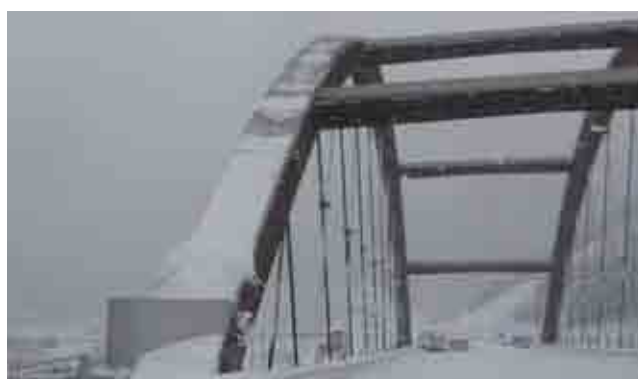
写真-7 落雪防止パネル滑雪状況(その2)
