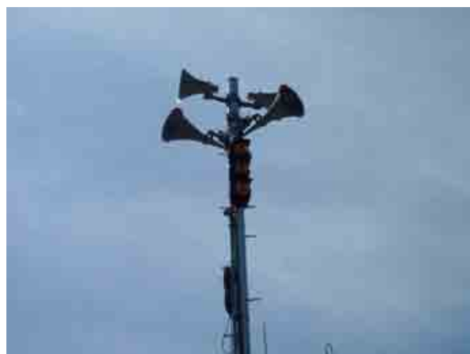
図-11 五條市防災無線支柱回転灯設置写真
