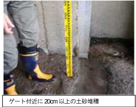
写真-1 名松樋門現地調査時のゲート下部の状況
