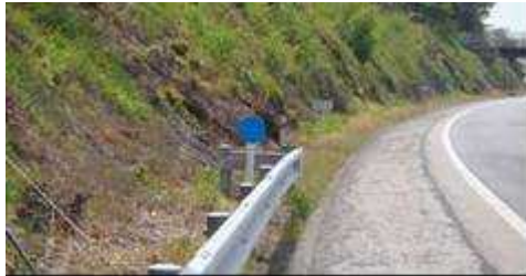
図-21 切土の危険箇所標示(青色灯)
