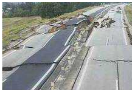
図-6 中越地震時の高速道路の被災状況
