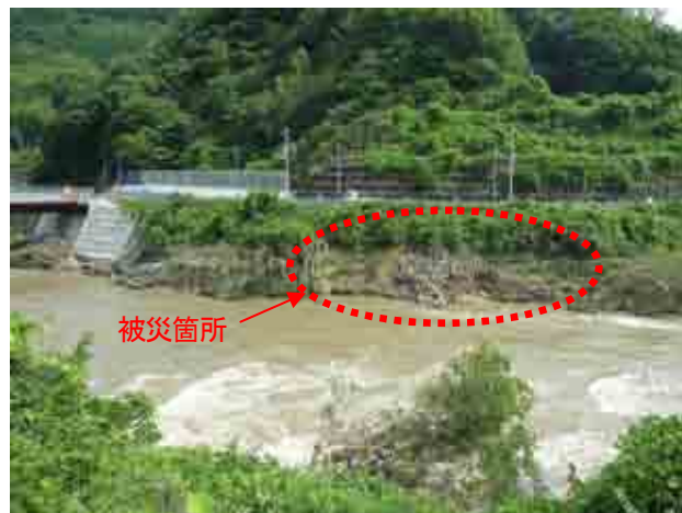
写真 - 4 平成 24 年 7 月出水による被災状況写真
