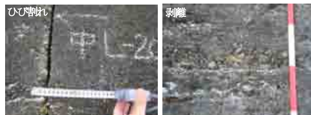
写真-5 損傷の状況
