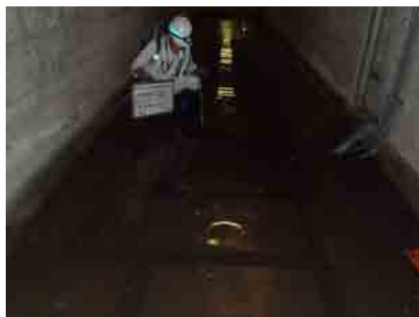
写真-6 共同溝内の浸水状況
