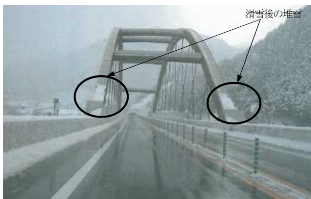
写真-9 供用後の落雪防止パネル滑雪状況
