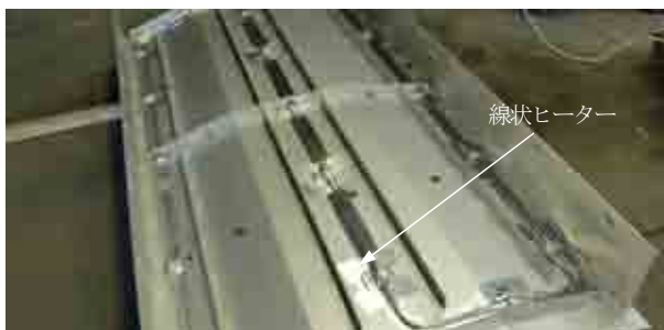
写真-2 落雪防止パネル 線状ヒーター固定(裏面)
