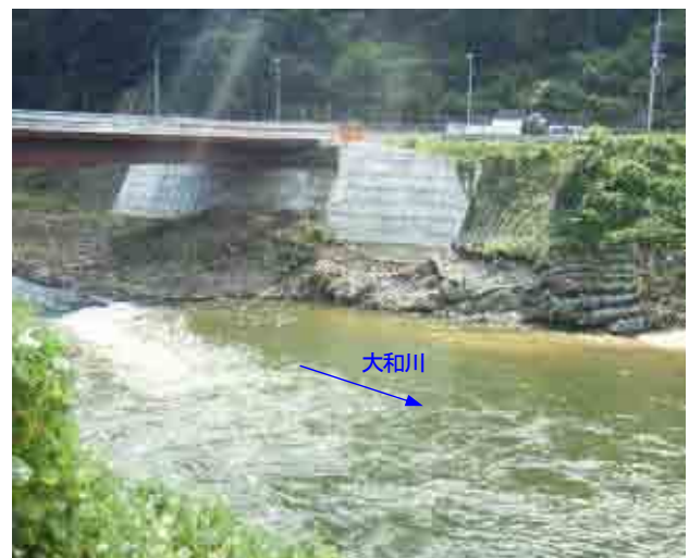
写真 - 1 被災写真
