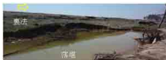
写真-7 堤防の裏法および落堀の侵食状況
