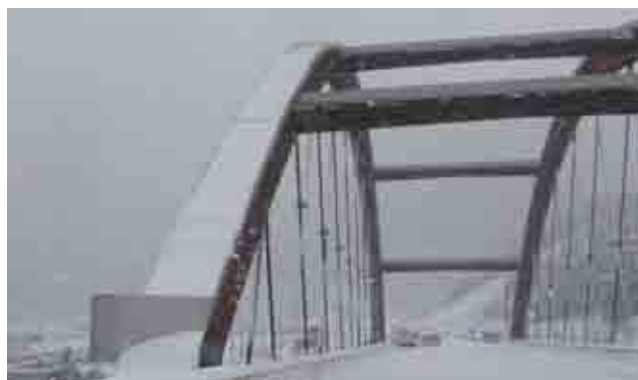
写真-6 落雪防止パネル滑雪状況(その1)
