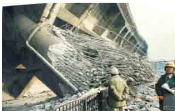
図-19 神 P136(西面) 20) (北東から南西方向に割れが発達・北西部に落下の痕跡)
