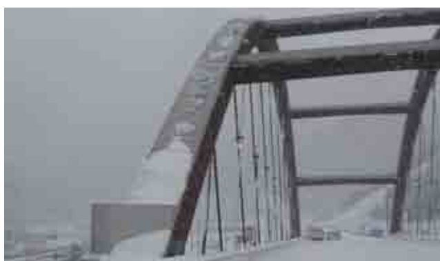
写真-8 落雪防止パネル滑雪状況(その3)
