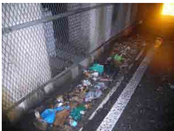
写真-4 冠水後の状況
