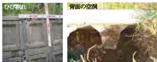
写真-2 損傷の状況
