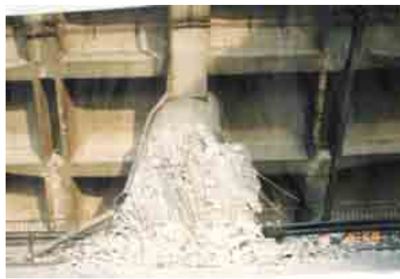
図-17 神 P134(南面) 20) (柱基部は北西側に着地、北東から南西方向に割れが発達)
