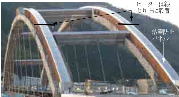
写真-1 落雪防止装置 取付け後
