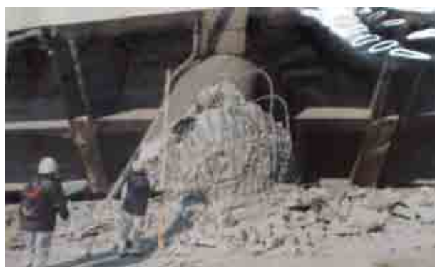
図-21 神 P140(南面) 20) (北東から南西方向に割れが発達・北西部に落下の痕跡)
