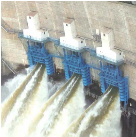
写真-1 ダム放流設備（天ヶ瀬ダム）
