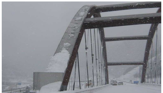
写真-8 落雪防止パネル滑雪状況(その3)
