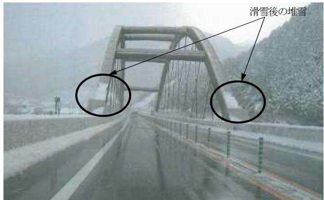
写真-9 供用後の落雪防止パネル滑雪状況
