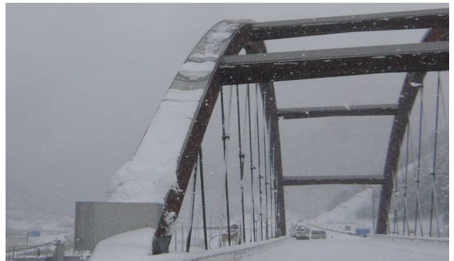
写真-7 落雪防止パネル滑雪状況(その2)
