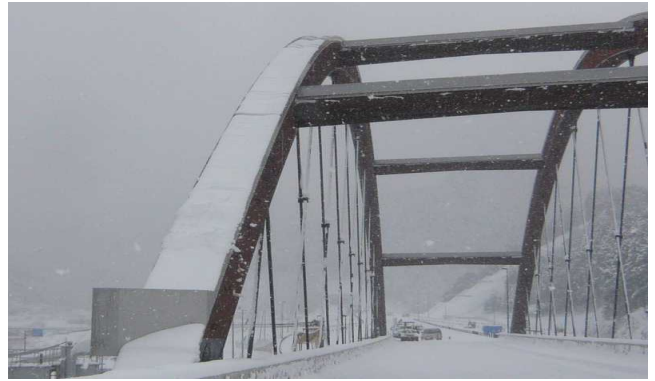
写真-6 落雪防止パネル滑雪状況(その1)
