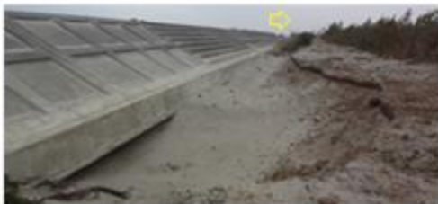
写真4 裏法先の侵食(巨理町荒浜)：レベルC
