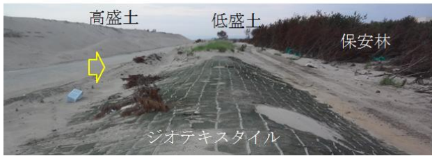
写真8 低盛土の覆土流出後のジオテキ補強部
