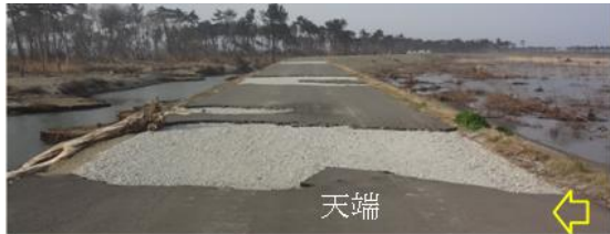
写真2 天端の軽微な剥離(仙台市井土浦)：レベルA
