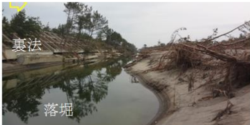
写真3 裏法尻の侵食による落堀(岩沼市寺島)：レベルB
