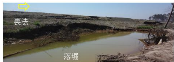
写真-7 堤防の裏法および落堀の侵食状況
