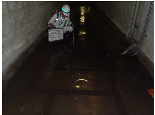
写真-6 共同溝内の浸水状況
