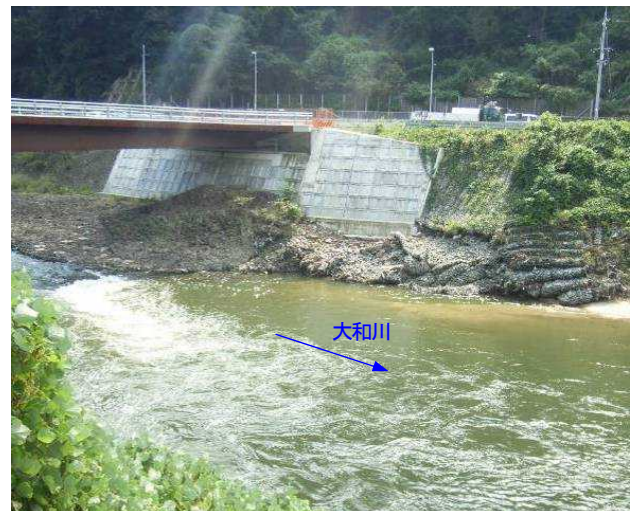
写真 - 1 被災写真
