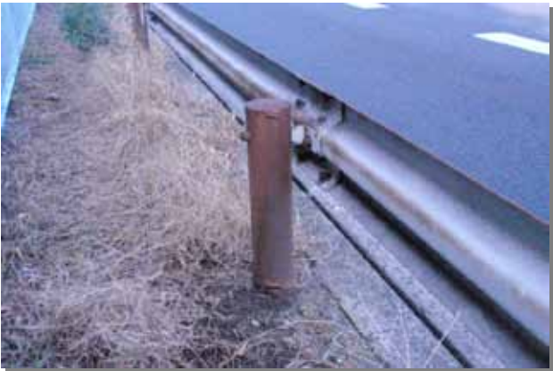
写真-1 土工部損傷状況
