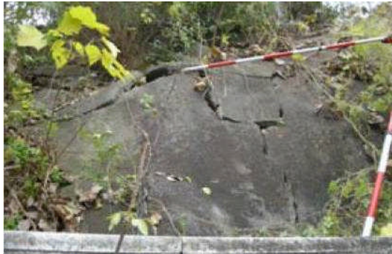
写真-3 適用事例② (上段；全景，下段；ひび割れ状況)
