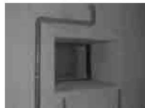
写真6 接続部（変電所側）
