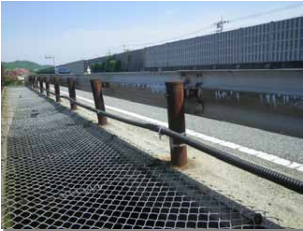
写真-2 橋梁部損傷状況
