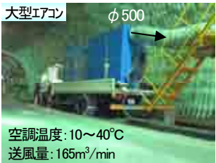
写真-8 大型エアコン
