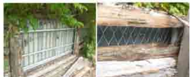
写真-18 10年が経過した金属製の土留柵
