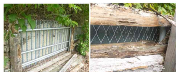
写真-18 10年が経過した金属製の土留柵
