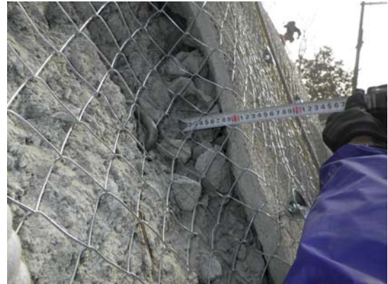
写真4.5 事例3 背面風化状況
