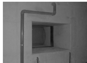
写真6 接続部（変電所側）
