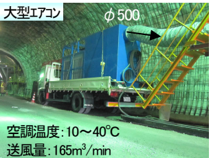
写真-8 大型エアコン
