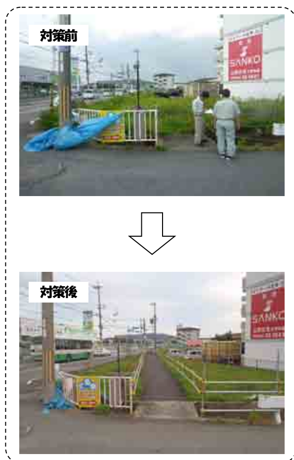
写真-4 国道168号の対策
