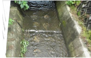
写真-6 コンクリートの川底にいくつもの穴
