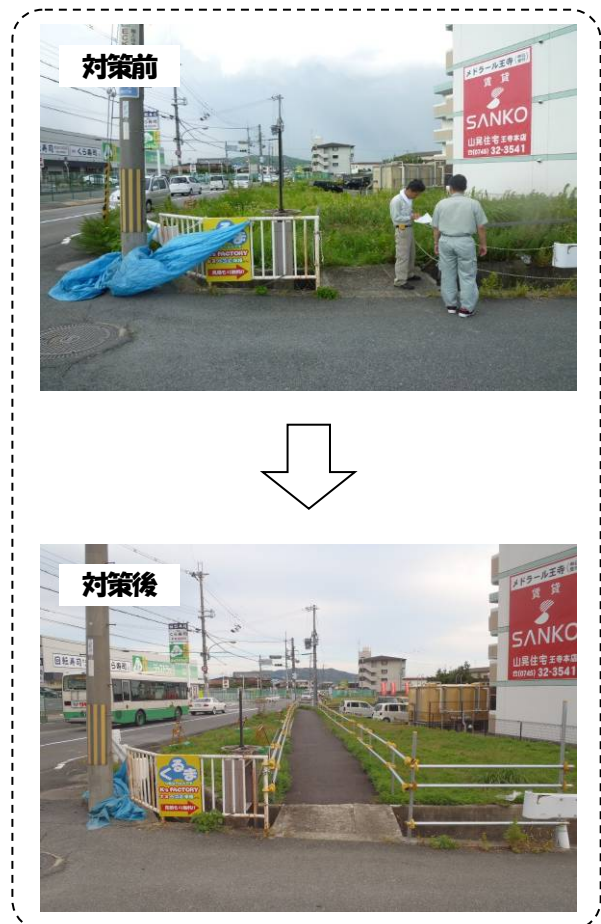
写真-4 国道168号の対策
