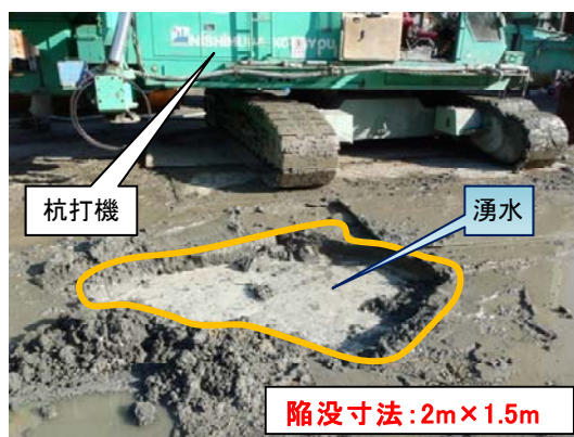
図-11. 施工基盤陥没状況
