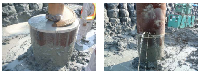
図-10. 被圧地下水溢れ出し状況
