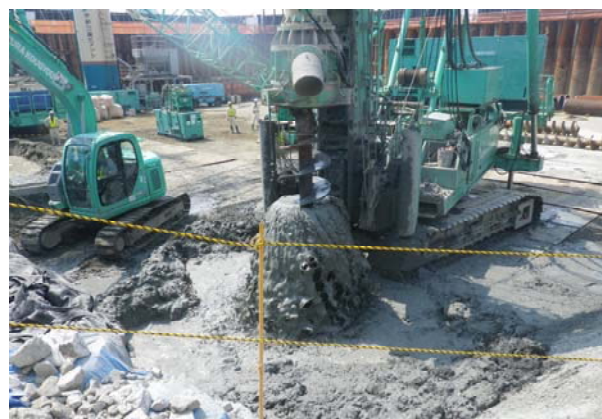
図-7. 被圧地下水噴出状況
