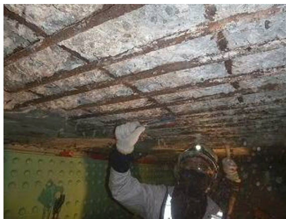
写真 5-6 既設床版鉄筋の発錆状況
