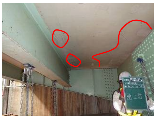
写真 5-2 床版補強異常音範囲 (赤枠内)
