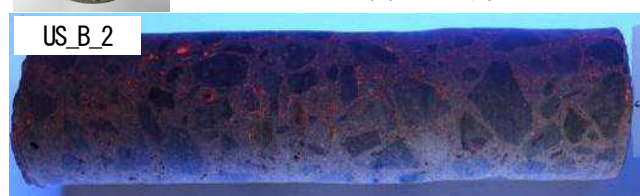
写真-3 ブラックライト照射によるひび割れ目視観察結果 (Model-B 上床版 ひび割れ No. 2)
