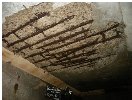
栈橋下面部の鉄筋露出状況
