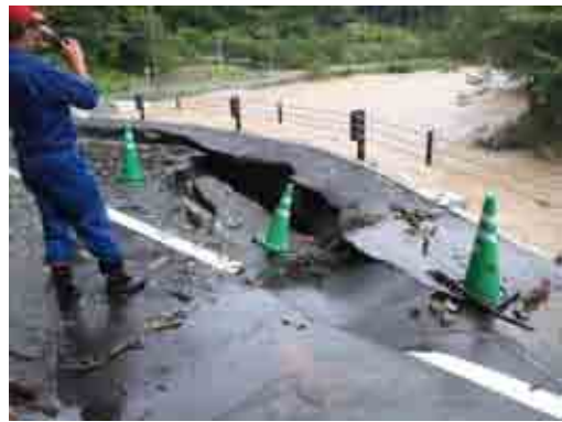
写真-1 被災箇所B (9/16 9:30頃)
