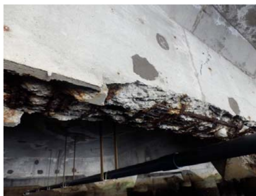
写真-2 棧橋下面 梁の鉄筋露出
