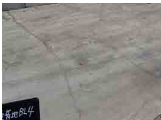
写真-3 エプロンのひび割れ
