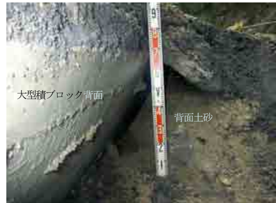
写真-5 大型積ブロック背面状況
