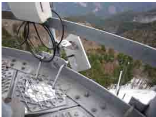
図-8 白六山無線中継所設置状況
