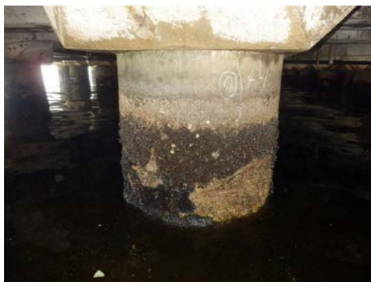
写真-4 栈橋下面 鋼管杭の腐食
