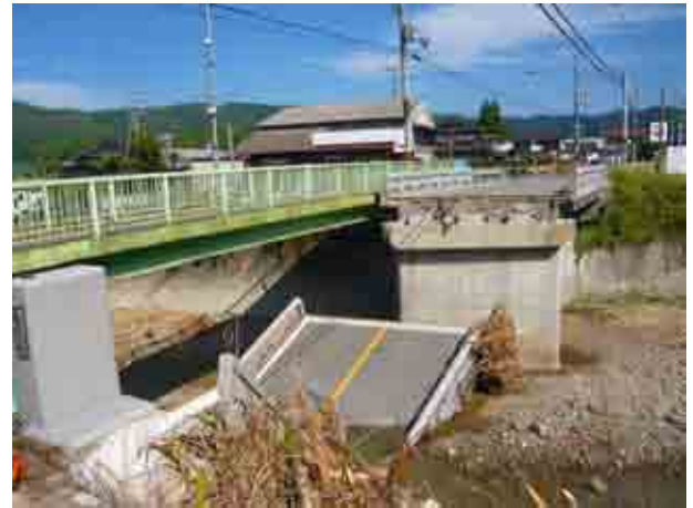
図-5 平成25年台風18号による国道162号の被災
