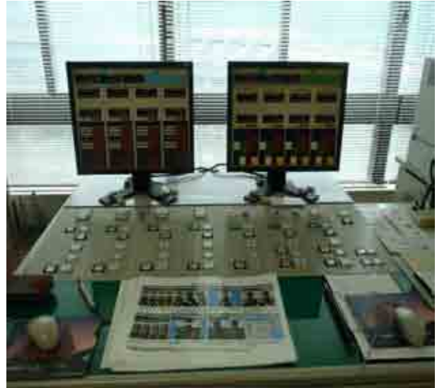
写真-8 遠方手動操作装置 操作卓
