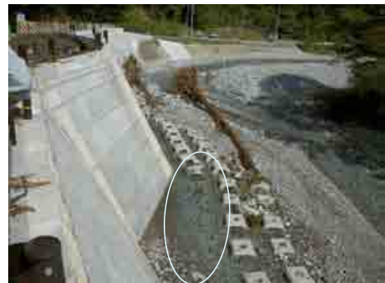
写真-6 根固ブロック変状
