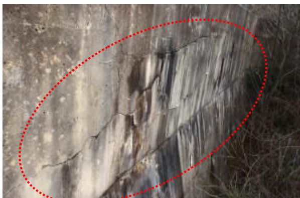
図 4-2 えん堤全面に広がったクラック
