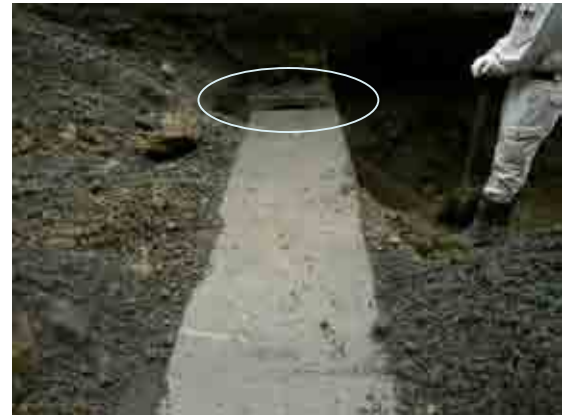
写真-4 横断管変状（奥が川側）
