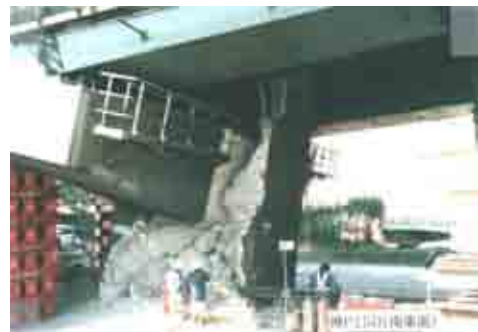
図-11 神 P150, 圧縮破壊だが裸鉄筋直立 21)
