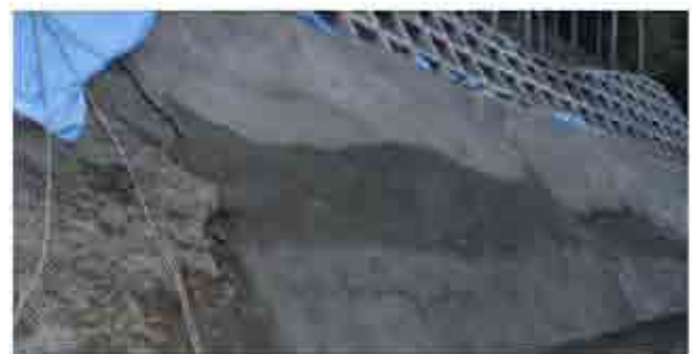
写真3. 3 大規模崩壊直前の法面状況
