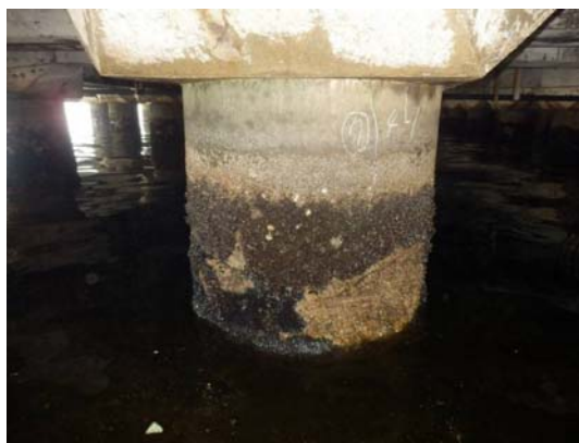
写真-4 栈橋下面 鋼管杭の腐食
