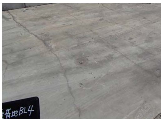
写真-3 エプロンのひび割れ
