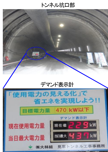
写真-4 デマンド表示計設置状況
