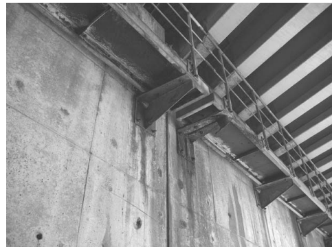
図-21 鋼製検査路の腐食状況
