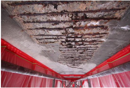
写真-3 床版下面の劣化（かぶり剥落）
