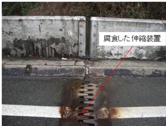
写真-4 壁高欄・伸縮装置の劣化状況
