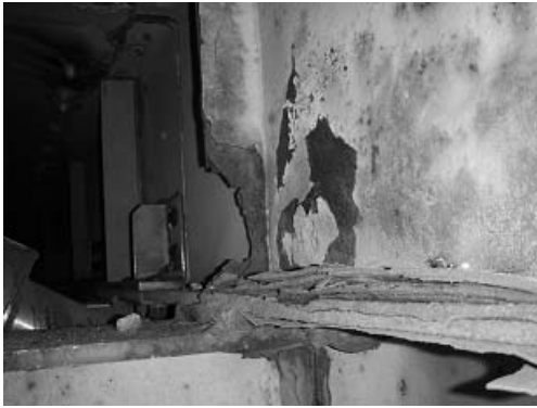
図-16 鋼桁の腐食状況
