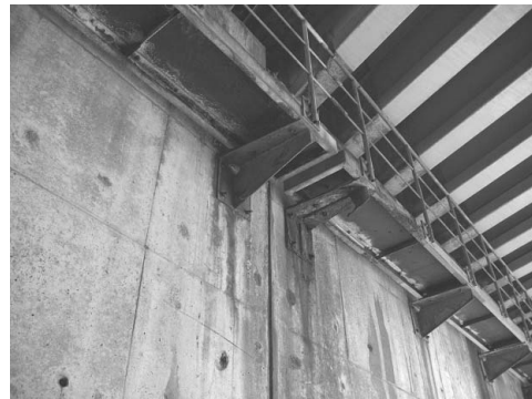
図-21 鋼製検査路の腐食状況
