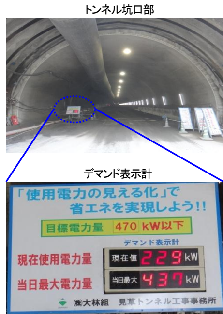
写真-4 デマンド表示計設置状況
