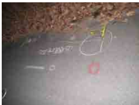
写真-7 漏水特定箇所①
