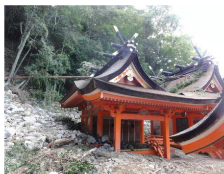
写真-1 熊野那智大社の被害状況 2)
