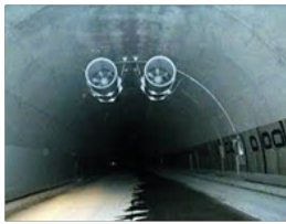
トンネル換気設備
