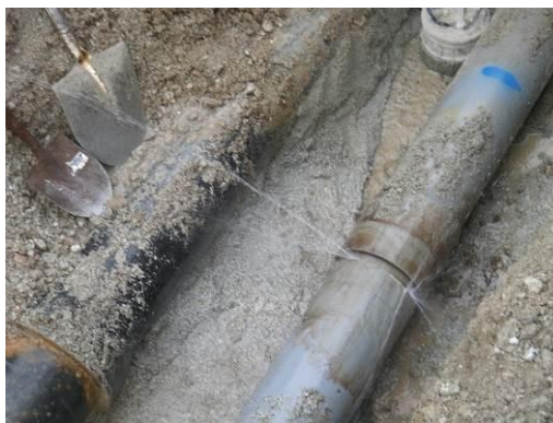
写真-13 漏水箇所
