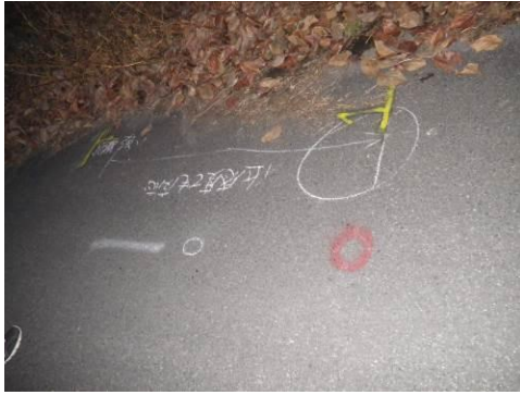
写真-7 漏水特定箇所①
