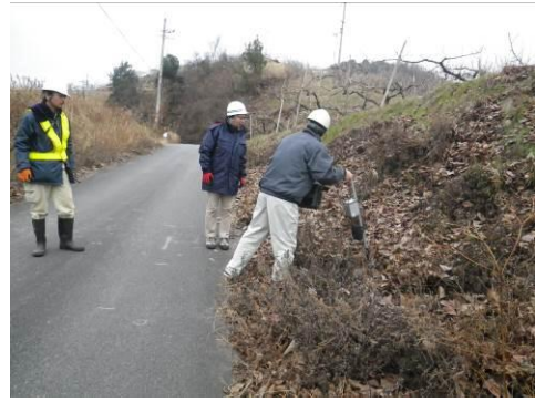
写真-8 漏水特定箇所②
