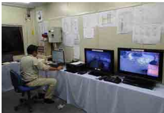
写真-1 中央監視室の状況
