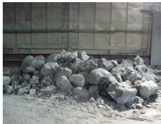
写真-4 硬質の玉石出現状況（沢部通過時）
