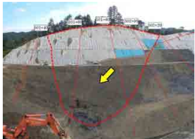
写真-3 変状を示した切土法面
