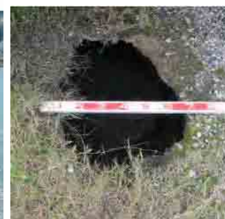
図-3 陥没発生箇所
