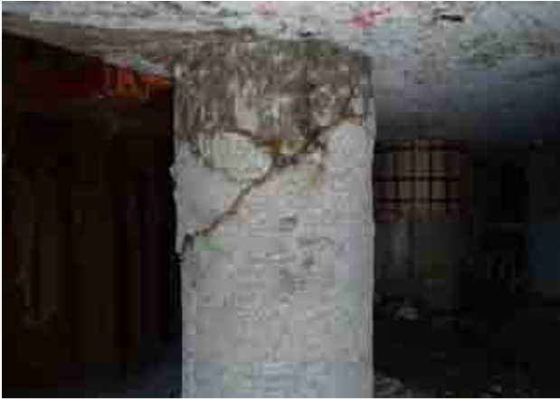
写真 3-3 : 杭頭部及び杭のせん断破壊
