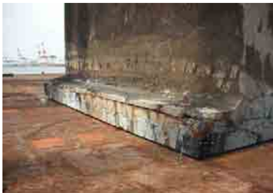
写真-5 ケーソン底板部のクラック状況
