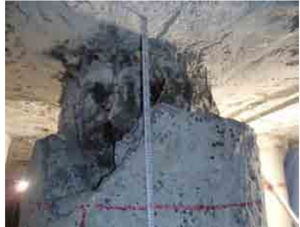
写真 3-2：杭頭部の曲げ破壊
