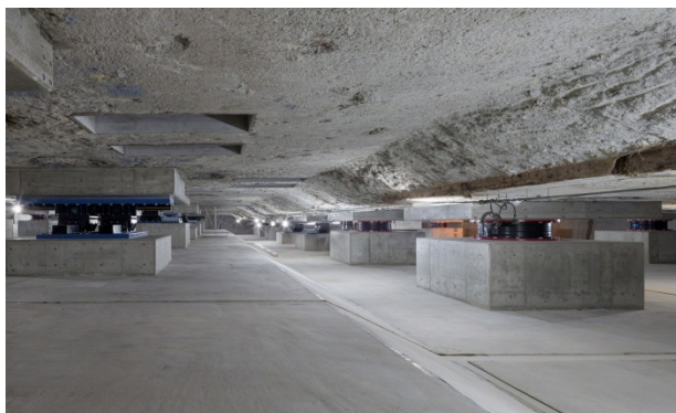
写真 2-4-1：竣工後の免震装置
