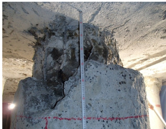
写真 3-2：杭頭部の曲げ破壊
