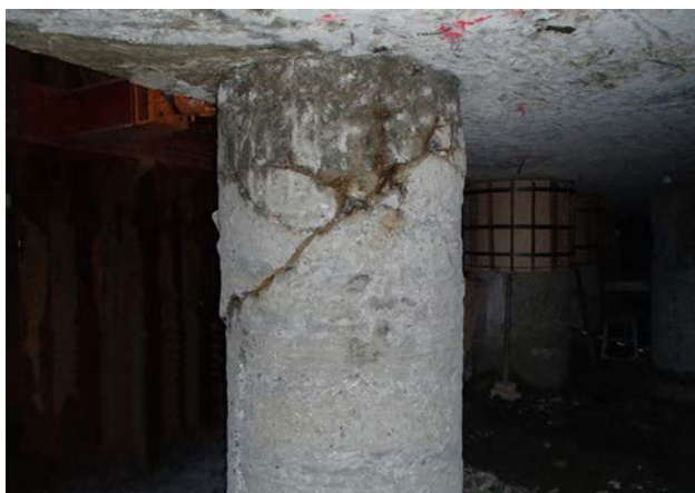
写真 3-3 : 杭頭部及び杭のせん断破壊
