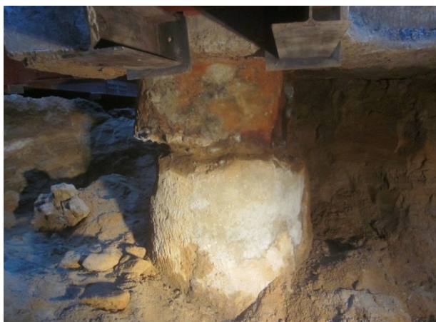
写真 3-1：杭頭接合部のずれせん断破壊
