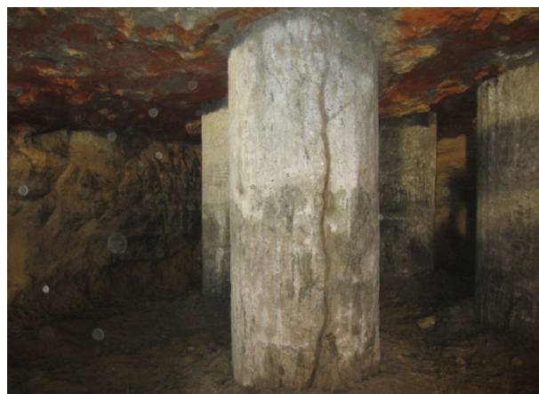
写真 3-4 : 縦方向のひび割れ
