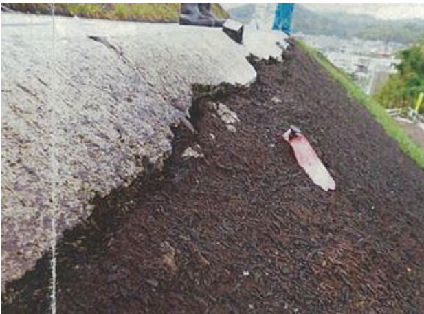
写真-1 表層すべりの兆候（小段下の隙間）
