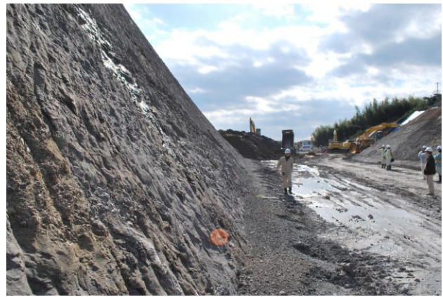
写真-2 スレーキングにより法尻に堆積した土砂
