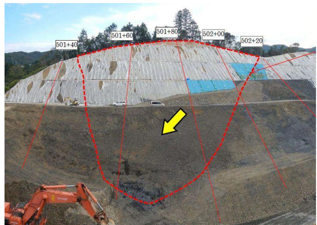
写真-3 変状を示した切土法面
