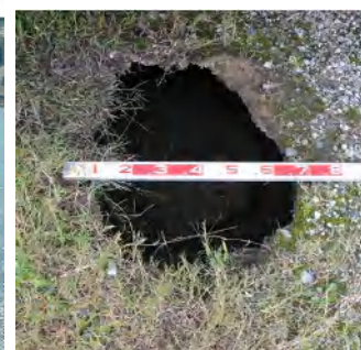
図-3 陥没発生箇所
