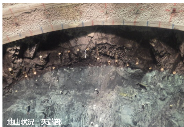
写真-2 地山状況: 割れ目も細かく軟弱な天端
