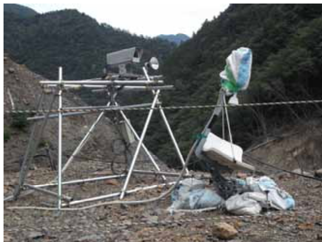
図-2 赤谷地区におけるKu-sat現地設営状況
