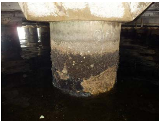
写真-4 栈橋下面 鋼管杭の腐食
