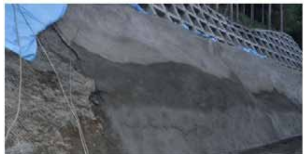
写真3. 3 大規模崩壊直前の法面状況
