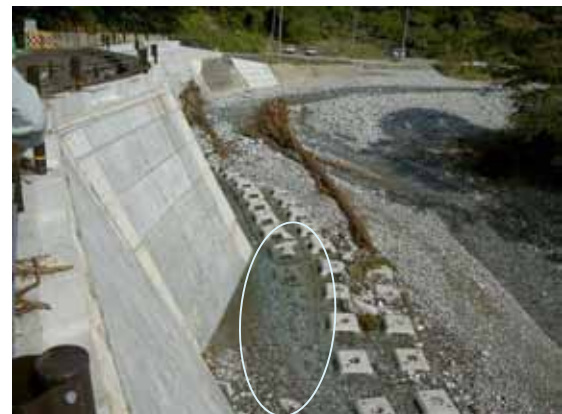
写真-6 根固ブロック変状
