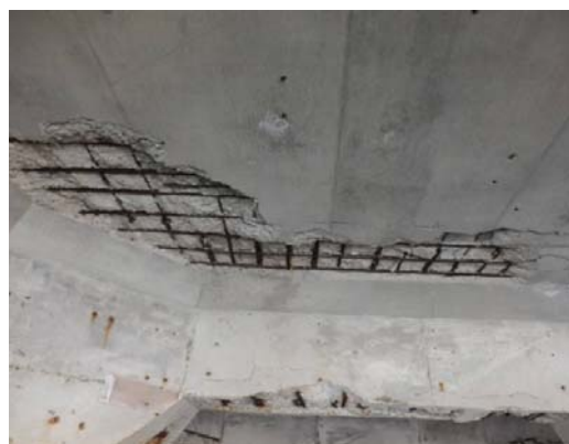
写真-1 棧橋下面 床版の鉄筋露出
