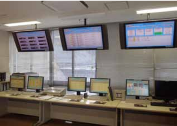
写真-3 放流操作設備
