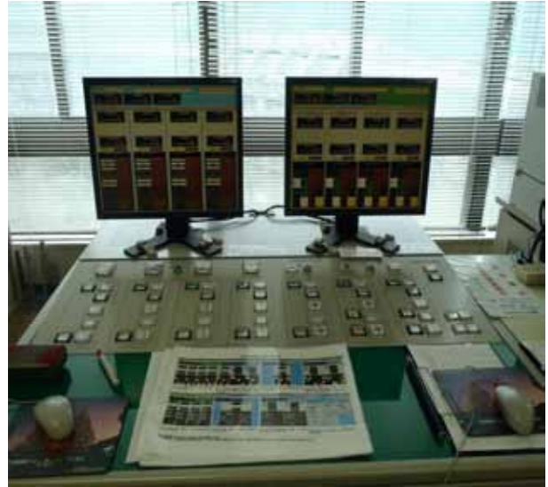
写真-8 遠方手動操作装置 操作卓
