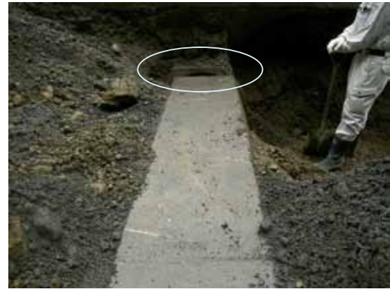
写真-4 横断管変状（奥が川側）
