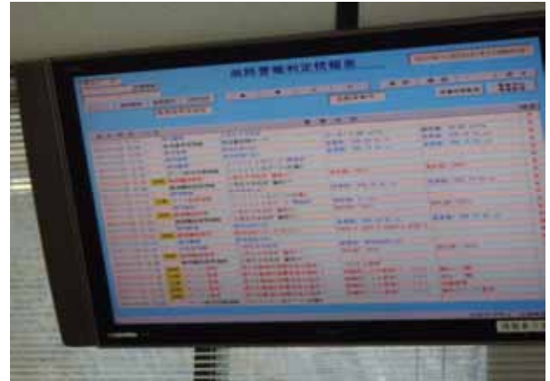
写真-5 障害発生対応訓練時のダムコン表示画面
