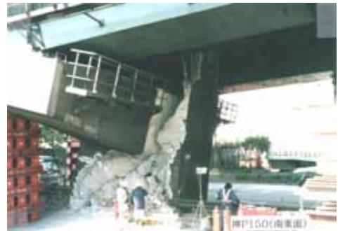
図-11 神P150, 圧縮破壊だが裸鉄筋直立 21)
