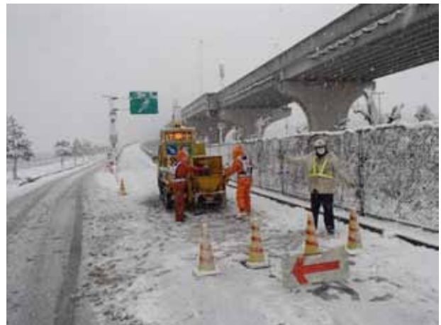
写真-1 大阪府内における積雪状況 (2014年2月14日 阪南市 国道26号 第二阪和国道石田ランプ付近にて)
