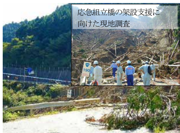
図-2 平成 23 年台風 12 号による国道 169 号の被災
