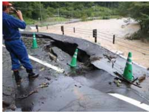
写真-1 被災箇所B (9/16 9:30頃)
