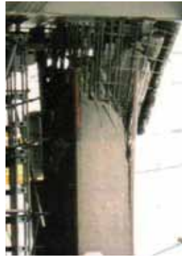
神P465(山側柱) 2,3,6,7) 図-7 引張破壊の代表例
