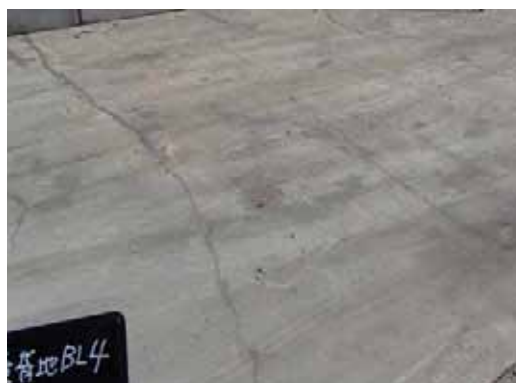
写真-3 エプロンのひび割れ
