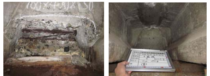
写真-1 横桁及びPCケーブルの破断状況
