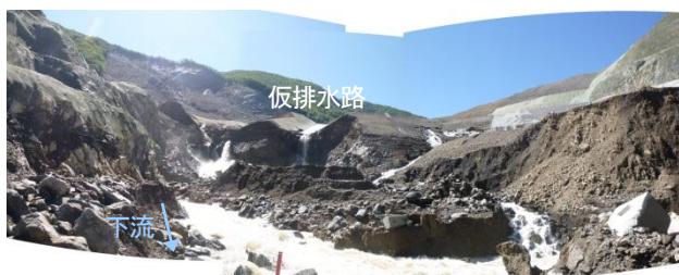
写真-6 仮排水路直下の洗掘状況
