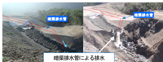
写真-13 仮排水路直下侵食状況（左：被災前，右：被災後）
