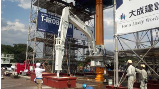
図-9 コンクリート破砕状況
