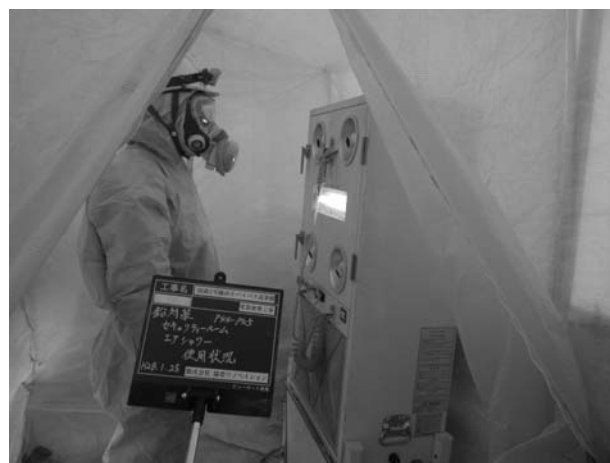
写真-9 浜手バイパス エアシャワー使用状況
