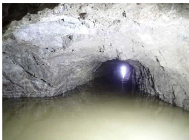
写真-5 対策工A区間の内部状況 (滞水あり)
