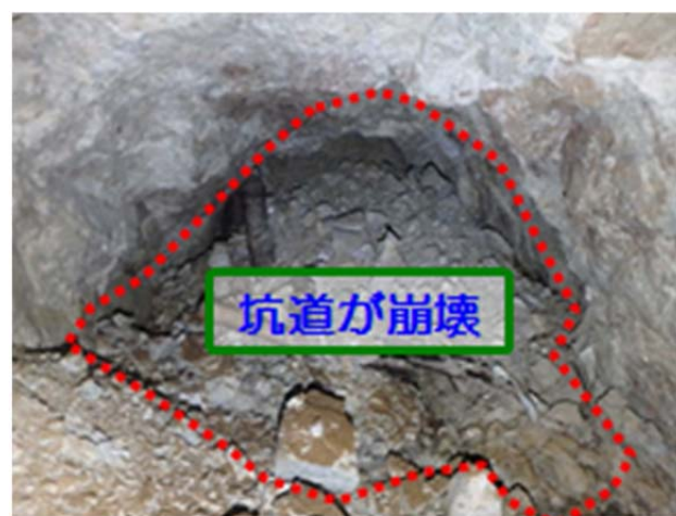
写真-10 坑道の崩壊状況 (対策工Dの先が埋まっている)
