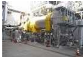
写真-1 汚泥乾燥機
