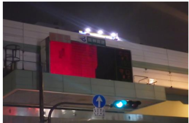
図-1 道路情報板異常点灯状態
